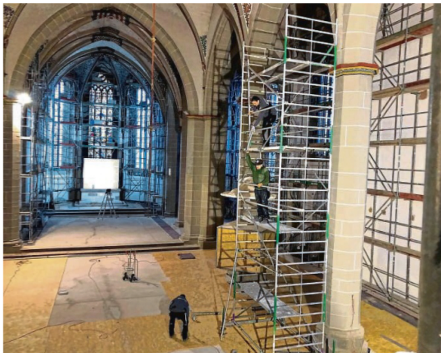
Viele Gerüste stehen in der Sixti-Kirche. Sie dienen nicht nur dem Innenanstrich der Seitenwände, sondern auch der Anbringung der neuen LED-Beleuchtung an den Säulen. Der Estrich auf der neuen Fußbodenheizung ist schon verlegt.
